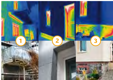
Abb. 56: Foto- und Thermographieaufnahmen von massiven Wärmebrücken bei einer Gebäudesanierung: dämmstoffdurchstoßende Balkonplatte (1); ungedämmte Fenster- und Türschwelle (2); ungedämmter Sockel aus Bruchsteinmauerwerk (3).
