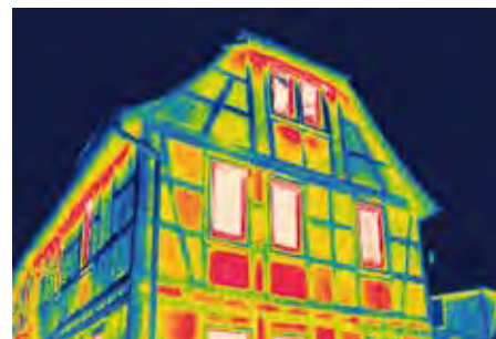
Abb. 22: Thermographieaufnahme eines Fachwerkhäuses. Das erkennbare Fachwerk wird bei der U-Wert-Berechnung flächenanteilig berücksichtigt.
